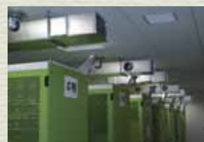
新東京データーセンター
